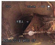
埋設管に侵入した根(写真提供:深谷沙氏)
