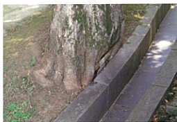
車道にはみ出した街路樹
