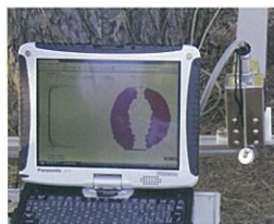
薄い部分が腐朽している。
